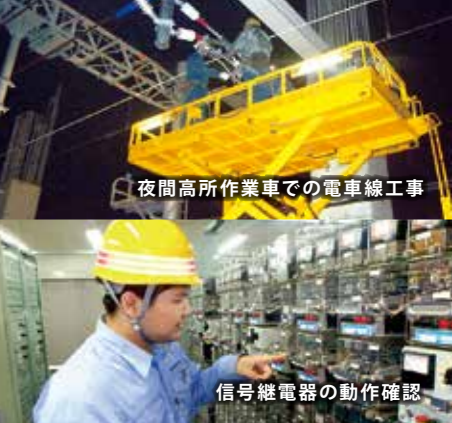
当社施工踏切設備
